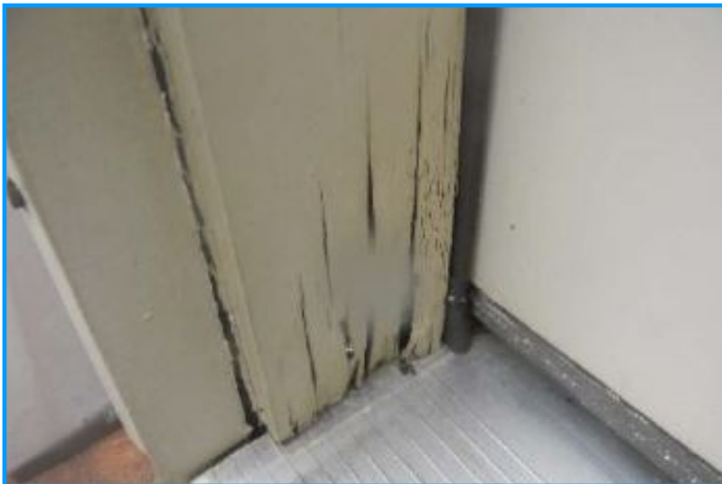
Rotted door jamb.
